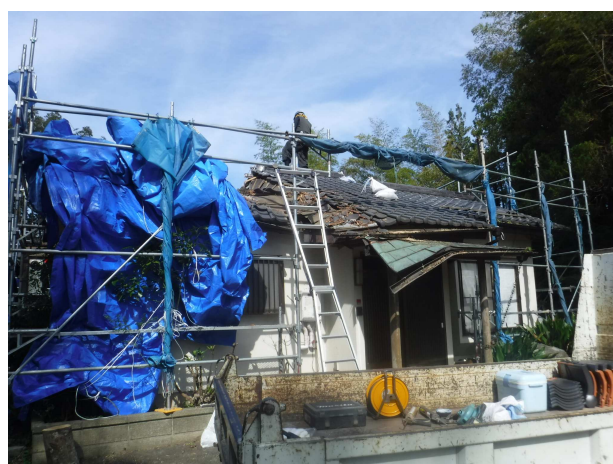
隣地の大木が倒れ、壊れたグループホーム、成田市
